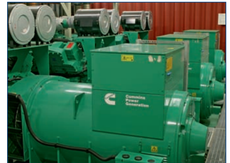
Generatoren zur Energiegewinnung
